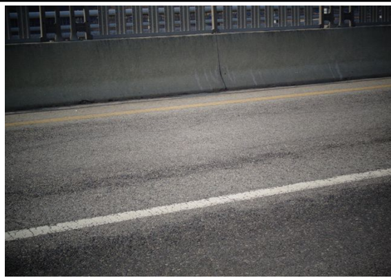
S9 아스콘 균열 (양평방향)
