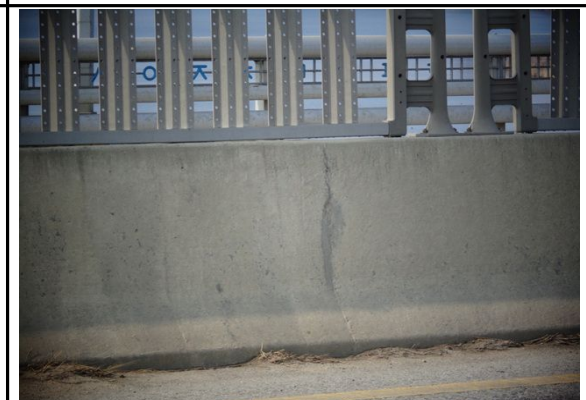
S24 중분대 균열 (양평방향)
