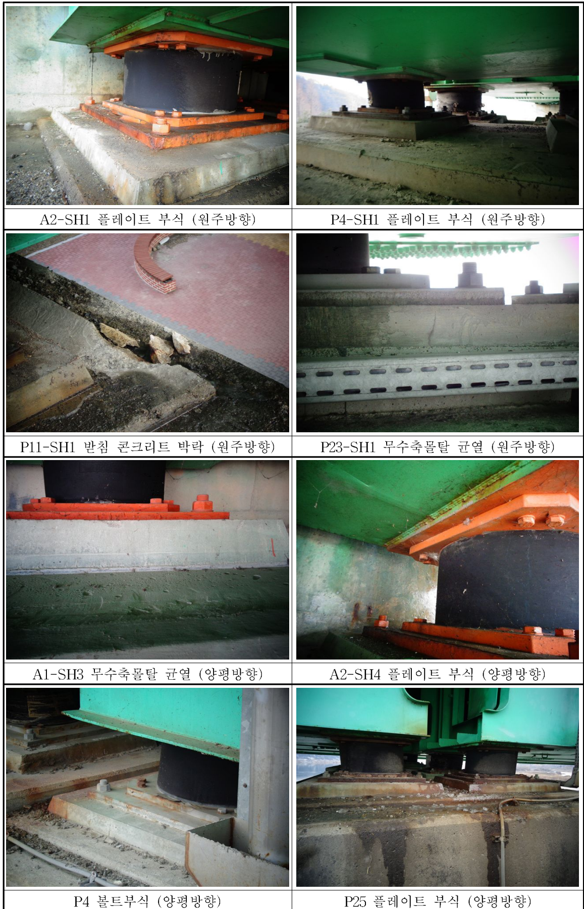
【그림 3.15】 교량받침 손상현황
