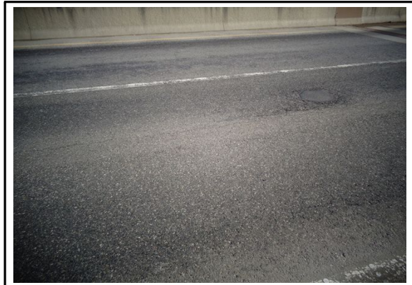
S5 아스콘 균열 (원주방향)
