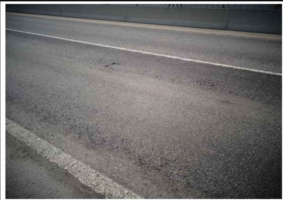
S15 망상균열 및 소성변형 (양평방향)
